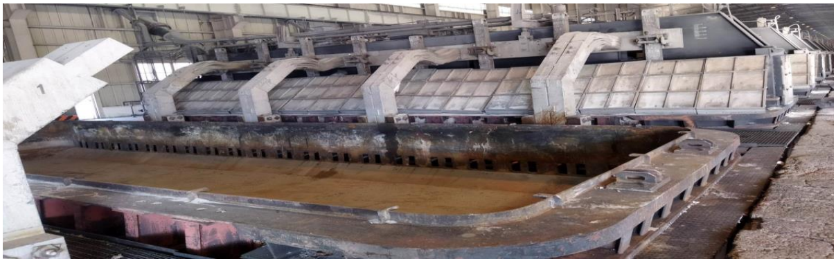
Şəkil 2. Gəncə Alüminium Kompleksində əsaslı təmir üçün sökülmüş və istehsalda olan elektroliz vannaları.
